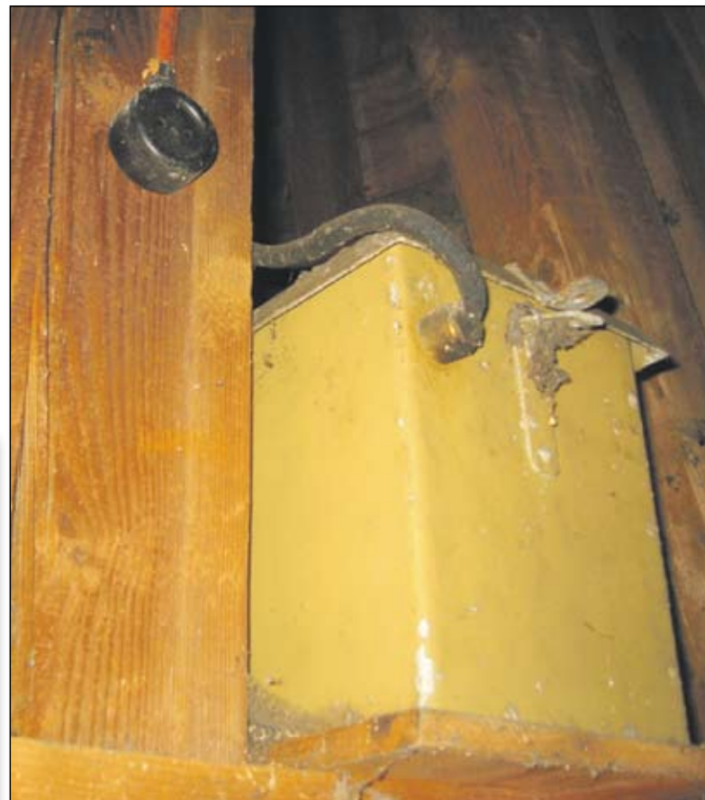
Detail van apparatuur in de spits.
