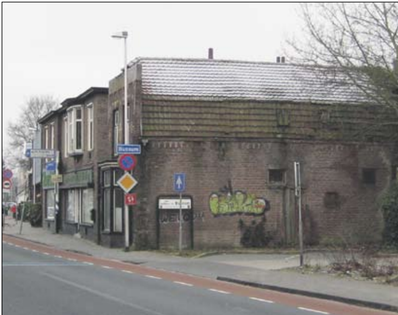
De huisnummers 2 en 4 zijn inmiddels verdwenen. Op nummer 6 ontbreekt de daklijst.
